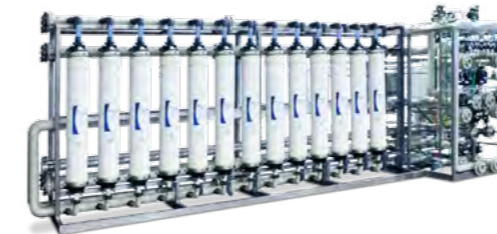
Skids modulares de Ultrafiltración
